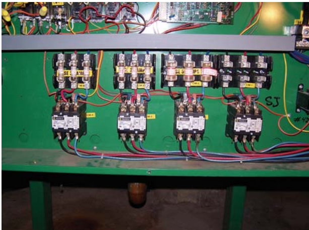
Figure 6 : Blocs de fusibles et contacteurs de la chaudière électrique Les fusibles du quatrième élément ont été retirés.
