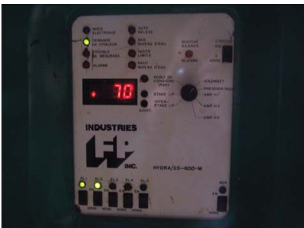
Figure 7 : Panneau de contrôle d'une chaudière électrique pour laquelle on a limité la puissance maximale à 70 kW en désactivant les éléments électriques
