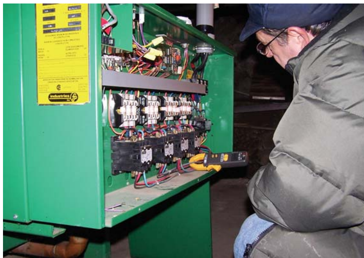
Figure 5 : Mesure du courant de la chaudière électrique
